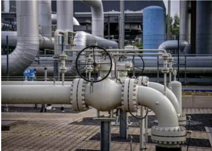
https://cdni.russiatoday.com/deutsch/images/2022.07/original/62d661aa48fbef7d9746ce77.jpg Gasspeicheranlage Reckrod bei Eiterfeld
