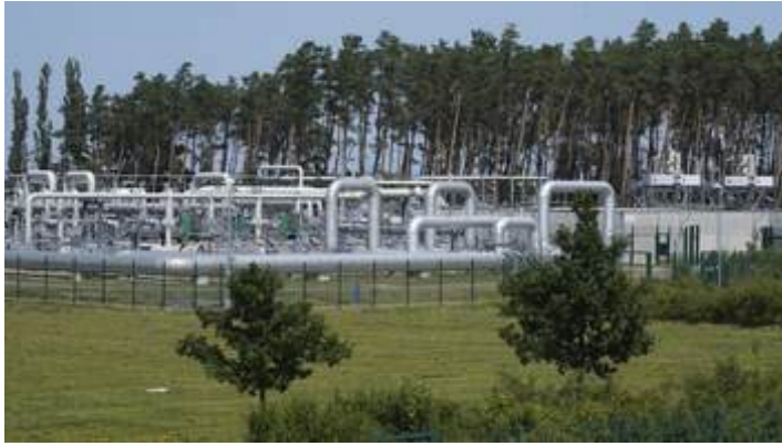
https://cdni.russiatoday.com/deutsch/images/2022.07/article/62d8e22cb480cc1078306ecf.jpg Rohrsysteme in der Industrieanlage der Ostseepipeline Nord Stream 1 bei Lubmin, 20.07.2022
